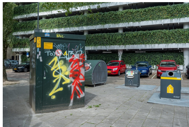
Afbeelding: Transformatorhuisje (IABR)
